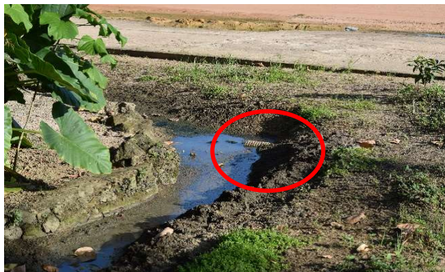
Figura 19: Esgoto lançado direto na Rua Cultura
