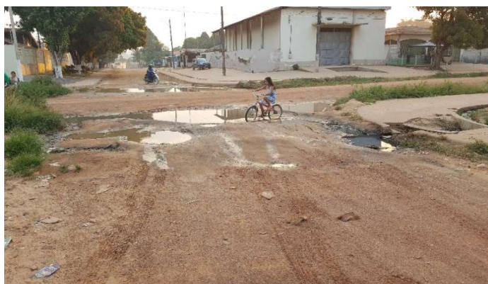
Figura 22: Criança andando de bicicleta entre poças de esgoto na Rua Primavera
